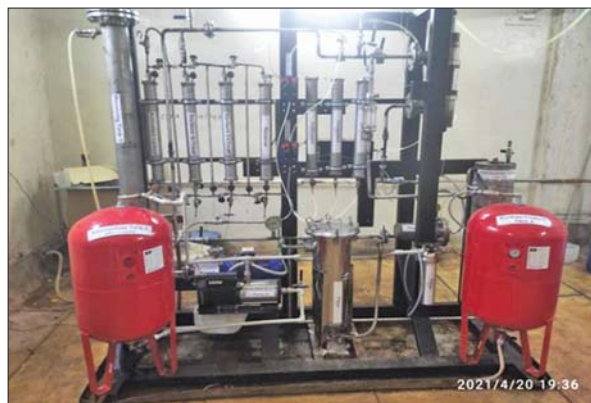
Рис. 2. Установка для очищення від радіонуклідів радіоактивно забруднених вод
