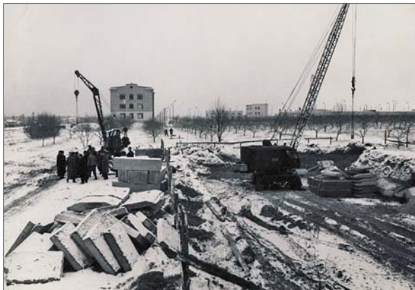
На закладанні фундаменту будівлі Інституту геофізики АН УРСР в Новобіличах, 18 грудня 1962 р.
