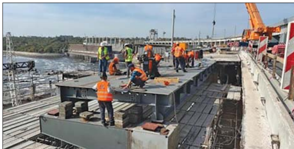
Автопроїзд греблею ДніпроГЕС. Технічний стан тримальних металоконструкцій після ракетного удару 22 березня 2024 р. і відновлювальні роботи
