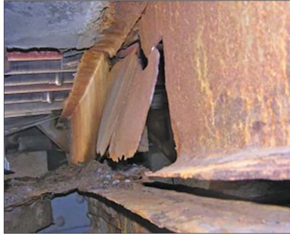
Руйнування поперечної балки на опорі № 1 моста Пана
