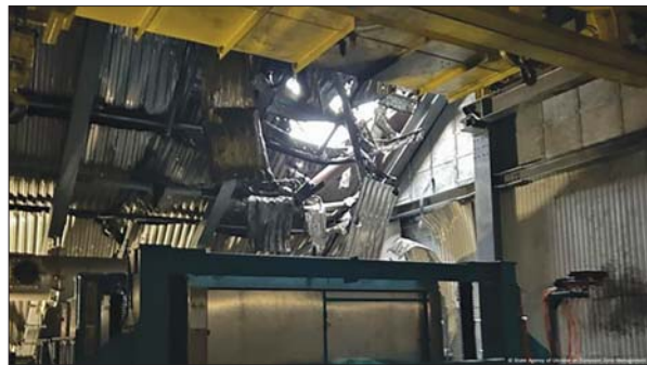
Пошкоджені конструкції Нового безпечного конфайнменту (вигляд зсередини)
