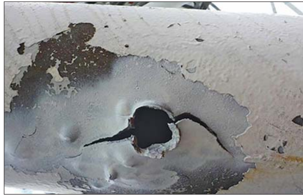
Наскрізний отвір у стінці труби опорної ноги київської телевежі від уламка ракети
