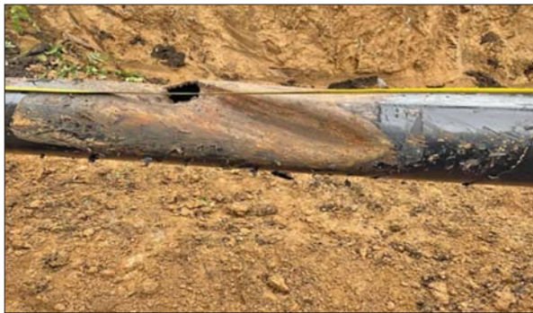
Рис. 2. Наслідки механічного впливу на трубопровід після зсуву
