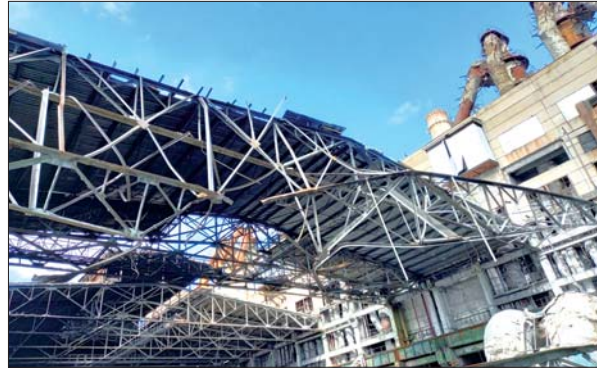
Рис. 9. Загальний вигляд руйнувань після ракетного удару по енергоблоках Зміївської ТЕС. 22 березня 2024 р.
