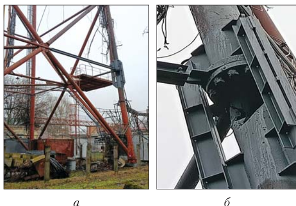
Рис. 6. Чернігівська телевежа після закінчення відновлювальних робіт: a — загальний вигляд; б — посилення пошкодженого вузла
