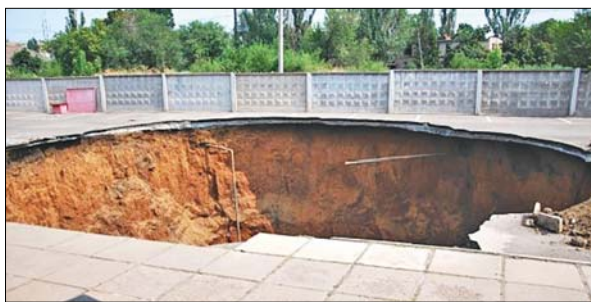
Рис. 8. Обвалення денної поверхні в селітебній зоні центру міста (гірничий відвід колишнього рудника ім. Ілліча)
