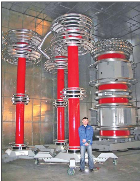
Рис. 5. Резонансна установка для випробування ізоляції кабелів напругою до 500 кВ
