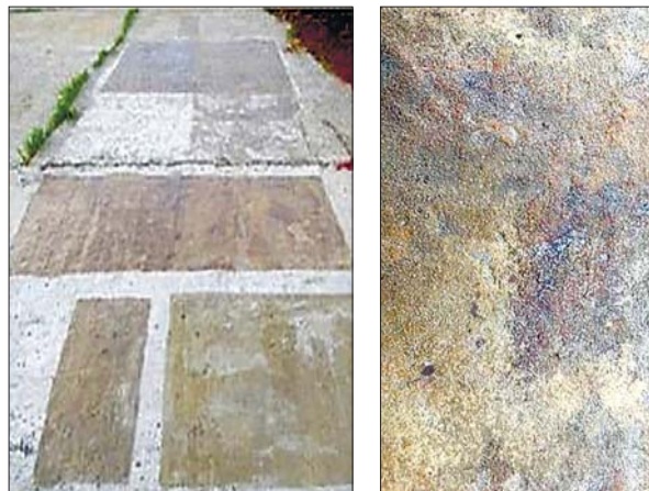
Рис. 3. Захисне полімерне покриття, нанесене на відкритому бетонному майданчику в липні 2017 р., станом на липень 2020 р. повністю зберегло свої властивості — не змінився колір, не спостерігається розтріскування та відшарування від бетону (ДП «Завод 410 цивільної авіації»)
